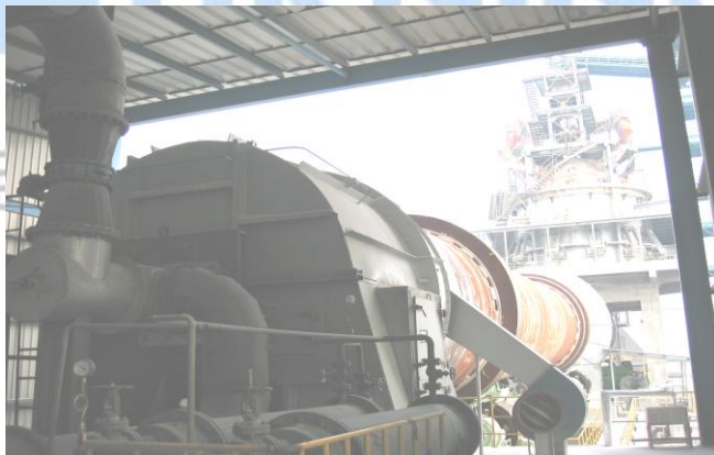
回转窑燃烧器现场使用照片
